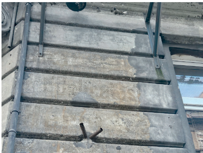
Fot. 4. Pozostałości inskrypcji, Wrocław, ul. Kniaziewiczza 15 Źródło: archiwum autorki.
